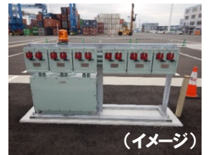
■冷蔵・冷凍用コンテナの電源プラグ
